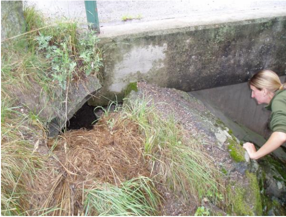
Fig 14. Roslagsbro: gryt under vägbanans överhäng.
