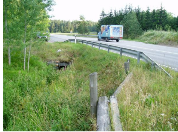
Fig 15. Flemmingsberg: längre underdimensionerad stenkulvert.
