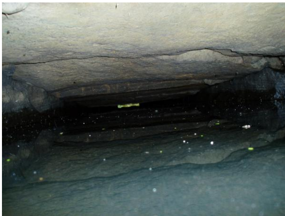
Fig 18. Norr om Karby: underdimensionerad kulvert, knappt med luftutrymme, kulverttakets speglar sig i vattenytan.
